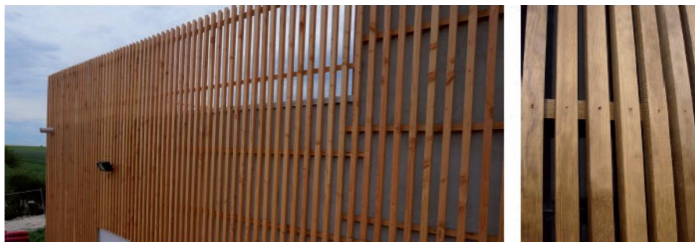
Photographie 58 : Exemple de bardage bois à claire-voie vertical garantissant l'intégration paysagère du poste de livraison tout en évitant l'installation des chiroptères attirés par le confinement
