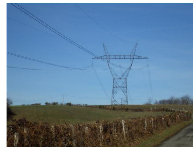
Photographie 16 : Ligne 400kV BREUIL-MARMAGNE (source : ENCIS Environnement)
