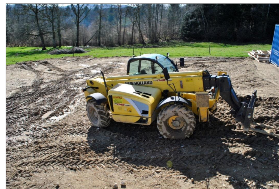
Photographie 45 : Exemple de tassement et d'ornières créés par les engins de chantier
