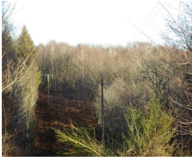
Photographie 17 : Ligne électrique HTA sur la ZIP (source : ENCIS Environnement)
